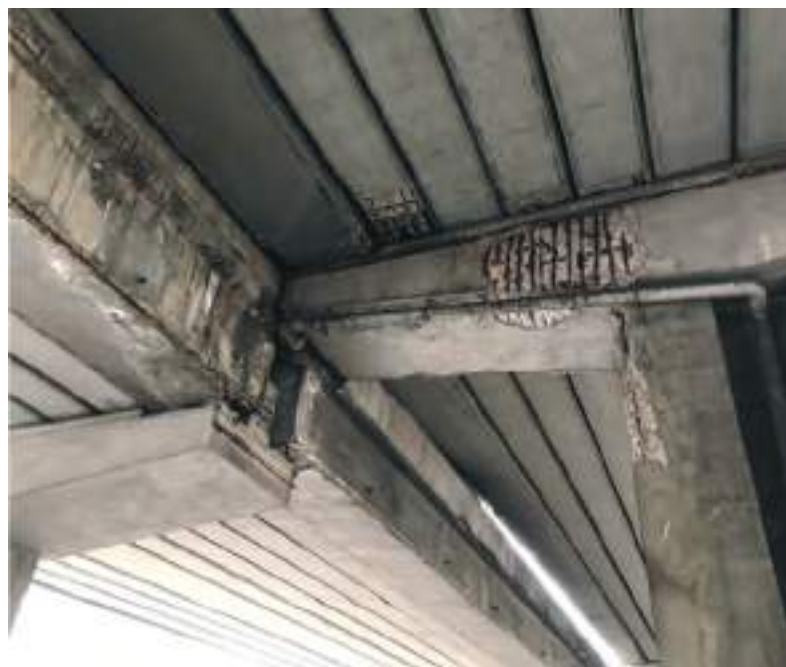
Figura 1 – Esempio di degrado nelle infrastrutture in cemento armato
