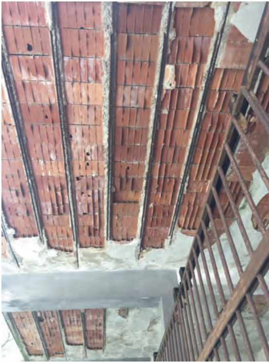
Foto 2 – Ossidazione “diffusa” delle armature per effetto della carbonatazione. È visibile, inoltre, lo “sfondellamento” delle pignatte.
