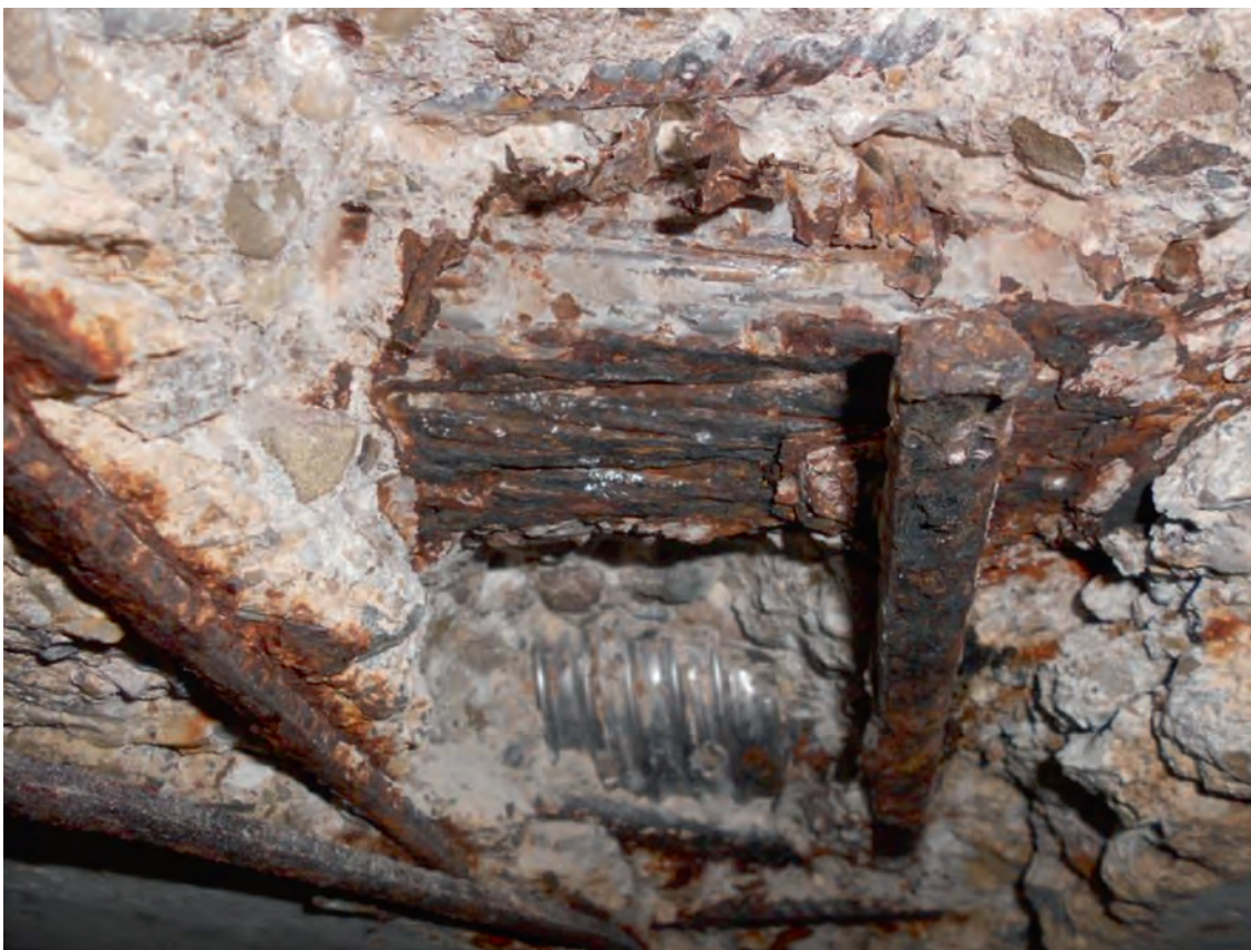
Foto 4 – Ossidazione dei trefoli – tensocorrosione – e delle armature lente per effetto combinato: carbonatazione in presenza di cloruri
