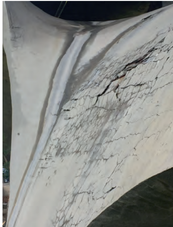
Foto 6 – Fessurazioni da ritiro idraulico sulla "membrana equi-compressa" del ponte sul Basento di Sergio Musmeci
