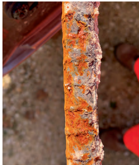
Foto 3 – Ossidazione “localizzata” di una barra di armatura per effetto dei cloruri
