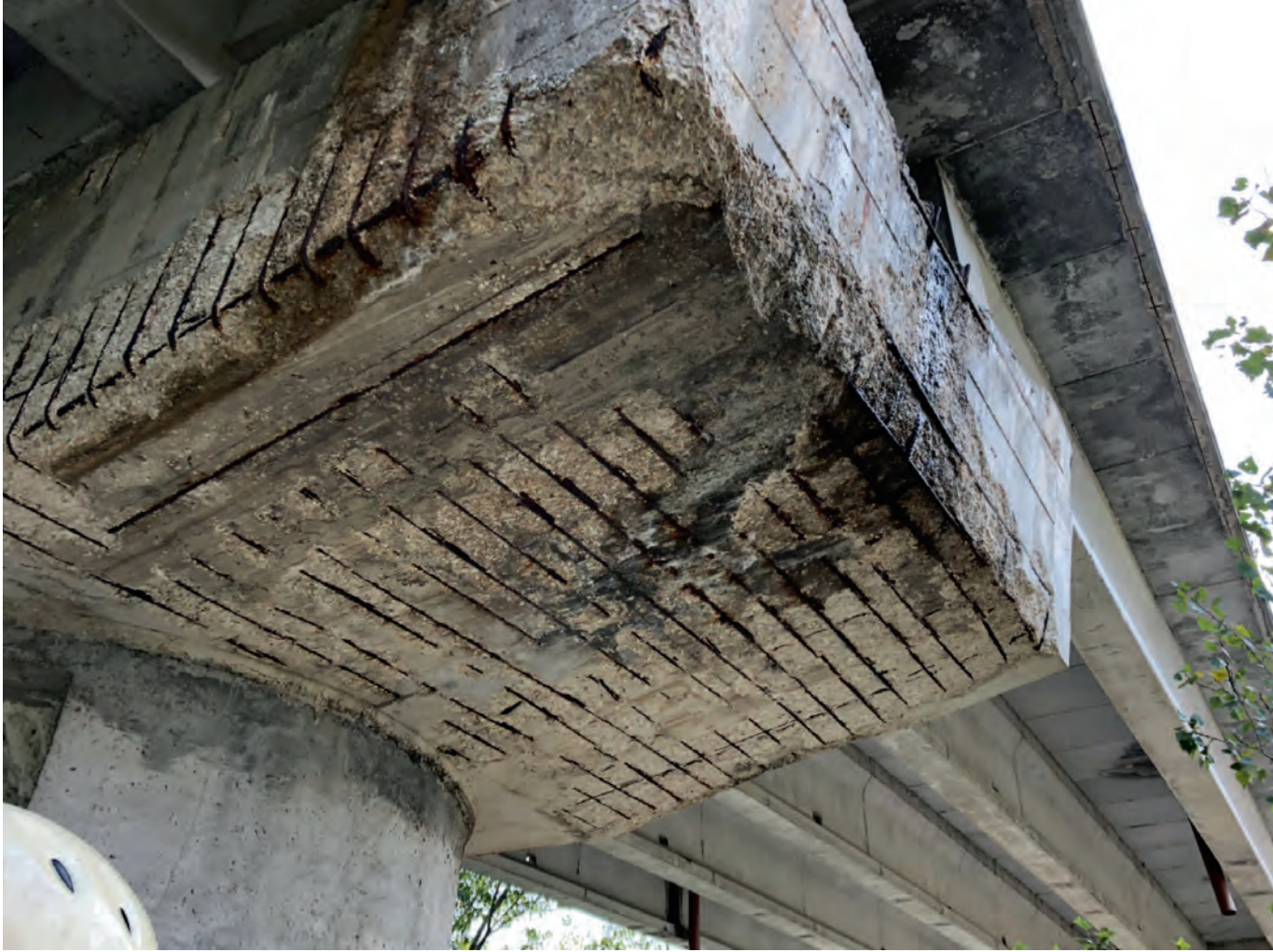
Foto 7 – Degrado per dilavamento della pasta cementizia
