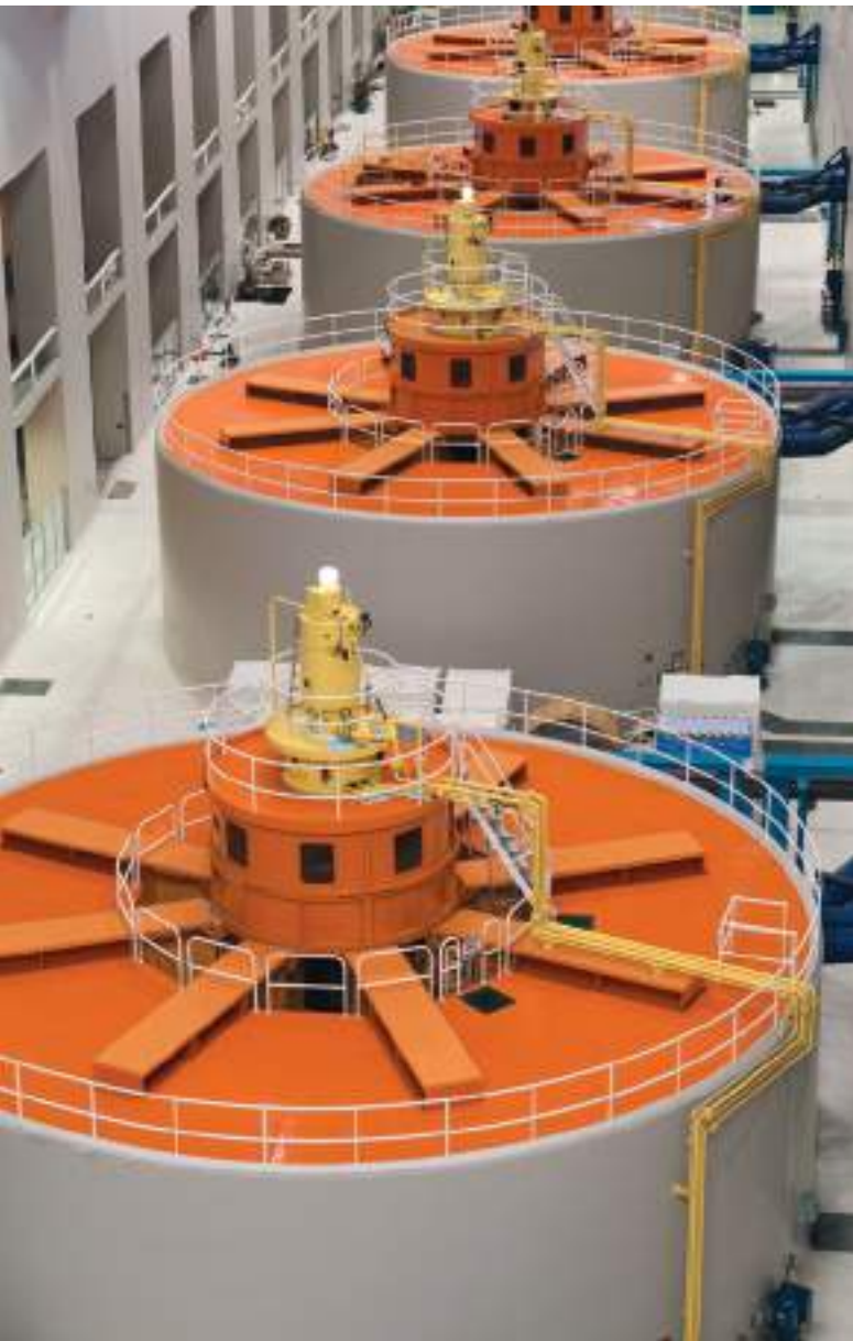
Generatori idroelettrici interni di una diga
