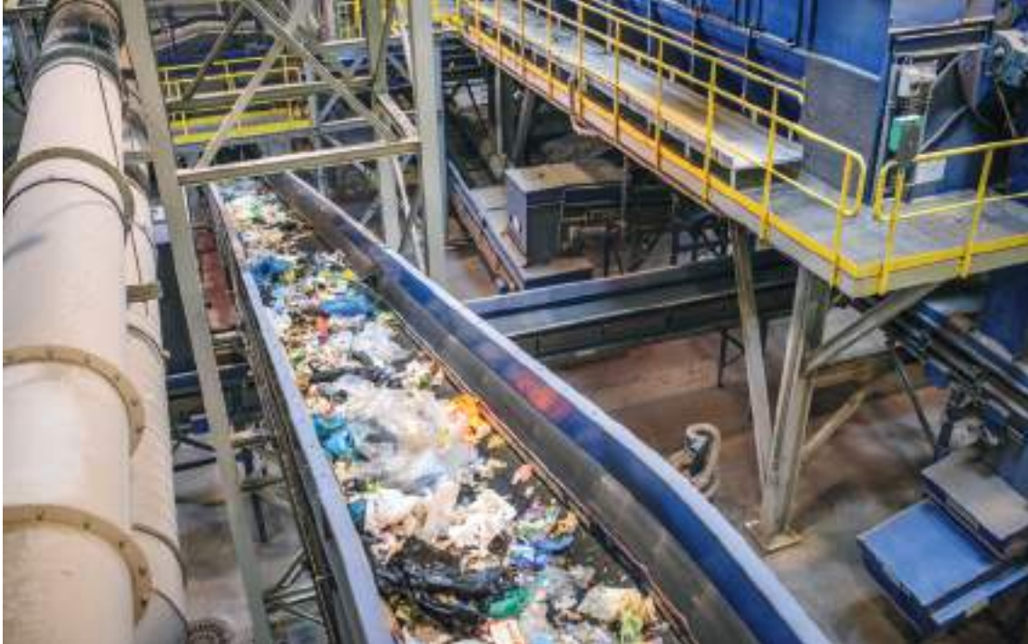
Impianto di trattamento dei rifiuti per recupero di energia mediante la termovalorizzazione di frazioni selezionate dei rifiuti
