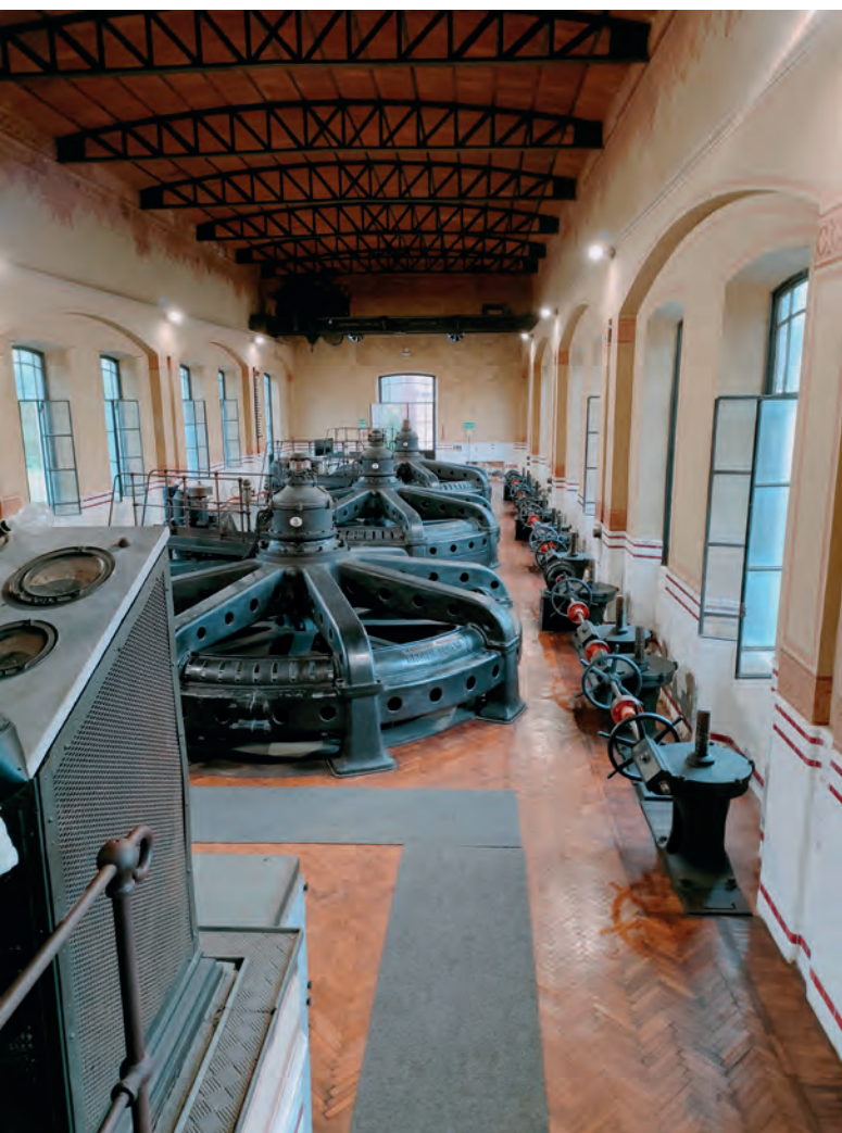
Fig. 16. Crespi d'Adda, centrale idroelettrica restaurata, galleria sala macchine
